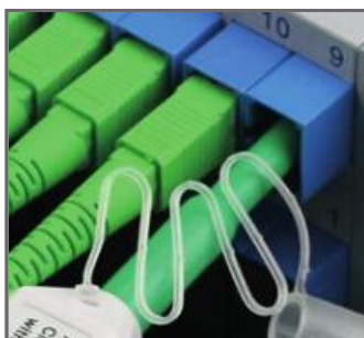
* Limpeza de conectores FC/SC/ST
